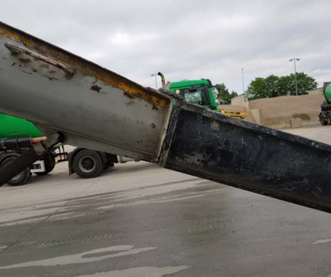
Abb. 16 Quetsch- und Scherstelle beim Einhängen der Verlängerung der Auslaufschurre
