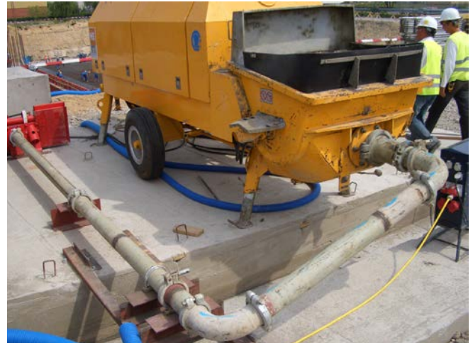
Abb. 40 Stationäre Pumpe mit Sperrschieber
